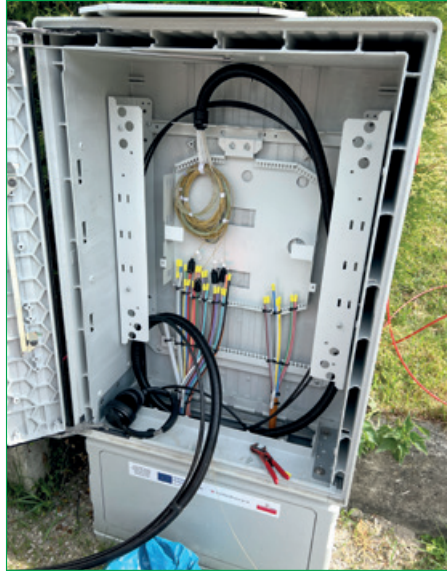
Glasfaserverteiler in Diepoltsdorf
